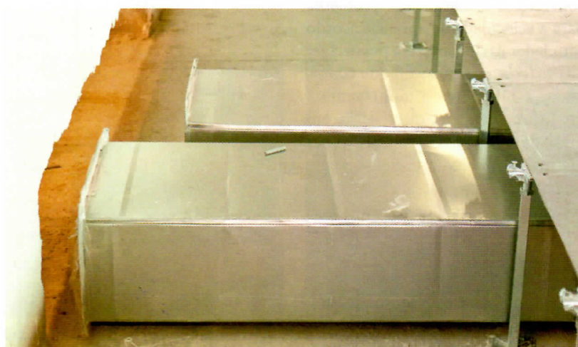
Insuflamento do ar-condicionado é feito pelo piso elevado porque assim o ar gelado é mantido até 1,70 m, o necessário para o conforto humano em um pé-direito de 2,50 m
